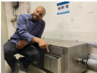
Emanuel Oyeleye, LuckyLunch Kempten nach der Installation des FiltaFOG Cyclone
